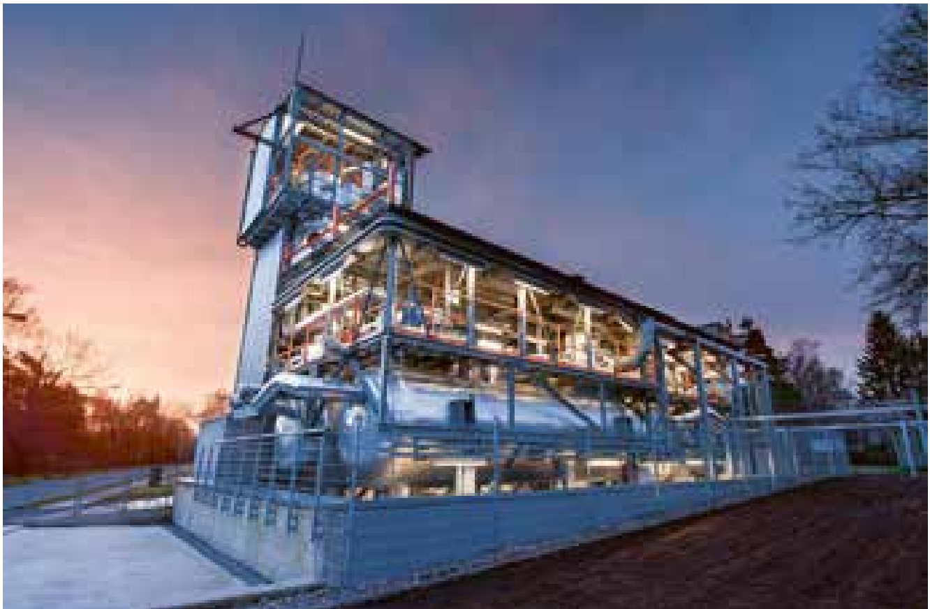
Die Testanlage für Wärmespeicherung in Salzschnmelzen (TESIS) des DLR-Instituts für Technische Thermodynamik in Köln dient der Entwicklung neuer Energie-Speichertechnologien auf Basis der Flüssigsalztechnologie.
