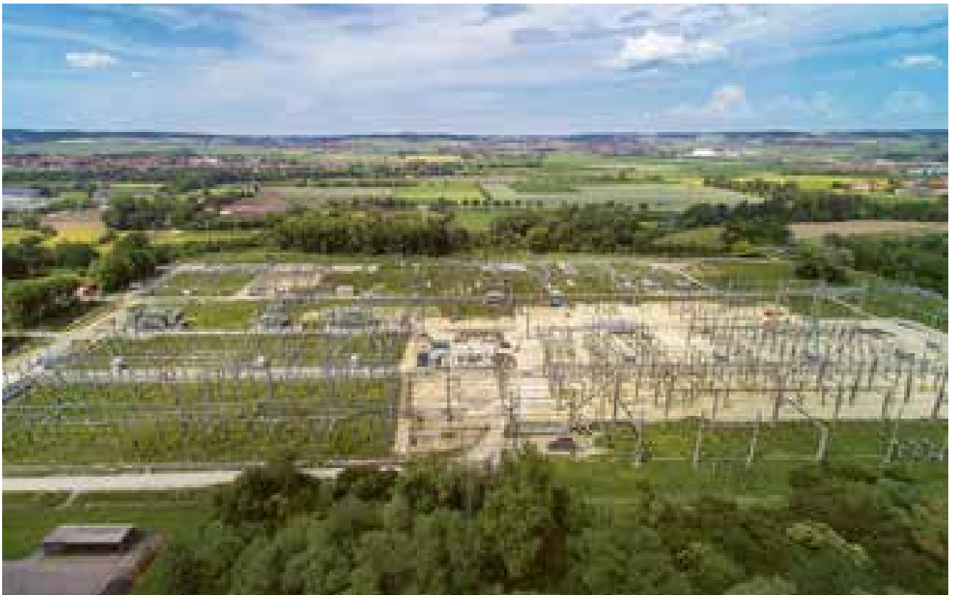
Umspannwerk Altheim, Bayern, nach der Modernisierung durch die SPIE Deutschland & Zentraleuropa GmbH, Ratingen
